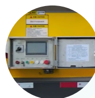
Panel de operación
